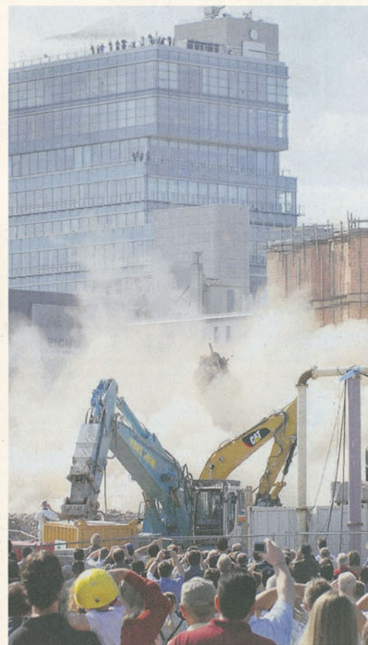
Sprengmeister Helmut Roller war am Ende sehr zufrieden. Eine leichte Aufgabe war diese Sprengung mitten in der Essener City indes nicht. Schließlich standen rundherum Gebäude, die nicht beschädigt werden sollten. Alles hat aber bestens geklappt. Derweil wird eifrig am zweiten Bauabschnitt des Centers gearbeitet. Fotos: Frank Vinken
