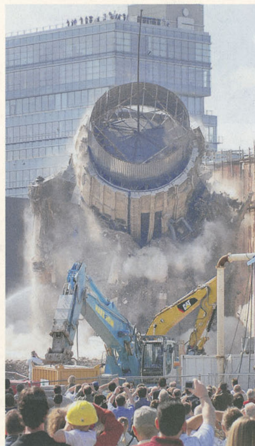
gereist, auch aus den Nachbarstädten, um das Spektakel zu verfolgen. Viel wurde unter den Anwesenden gefachsimpelt und abgewartet. Dann ein dumpfer Knall – und schon war es geschehen. Eine riesige Staubwolke bahnte sich den Weg vom fallenden Turm herab. Nur fünf Minuten später fiel auch das Stahltreppenhaus genau dort hin, wo es sich betten sollte.
